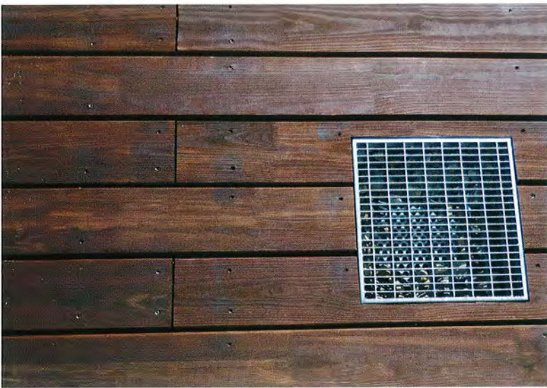
Gitter unter Abflussgulli – Foto: © T. Wilper
